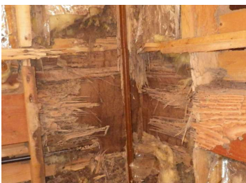
柱・胴差の被害
