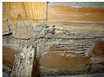
ヤマトシロアリによる木材の被害
